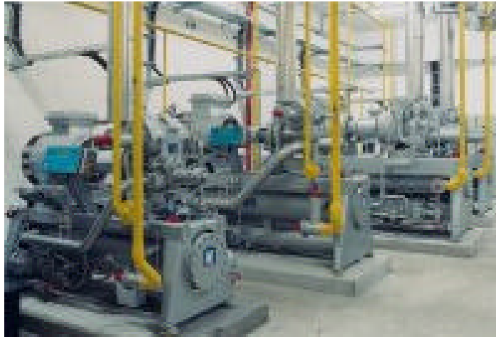
Figura 51. Detalle de los compresores.
